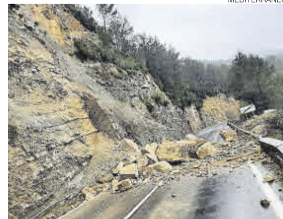
ESPADILLA. Cortada la CV-20 por desprendimientos.
